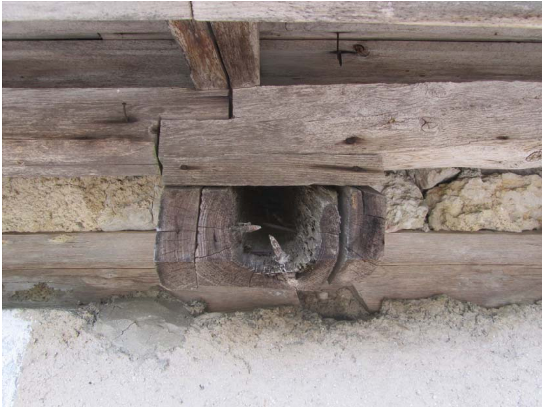
Le temps et les intempéries ont eu tout loisir de creuser les poutres extérieures de la charpente.
